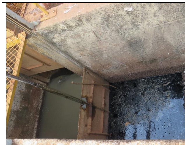
Autor: AMAE/RIO VERDE Descrição: sistema de by-pass da EEE Sapo. Destaca-se a diferença de aspecto do efluente reservado no poço de sucção e do efluente conduzido ao emissário da ETE Sapo. 14/07/22
