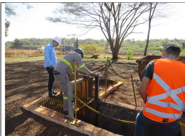
Autor: AMAE/RIO VERDE Descrição: abertura da comporta do poço de sucção pela prestadora para bombeamento do esgoto reservado para ETE Sapo. 15/07/22
